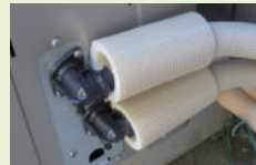
ヒートポンプ接続部
